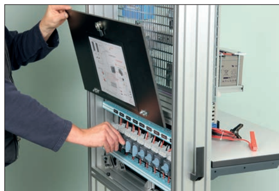
Trappe pour accès aux commutateurs
